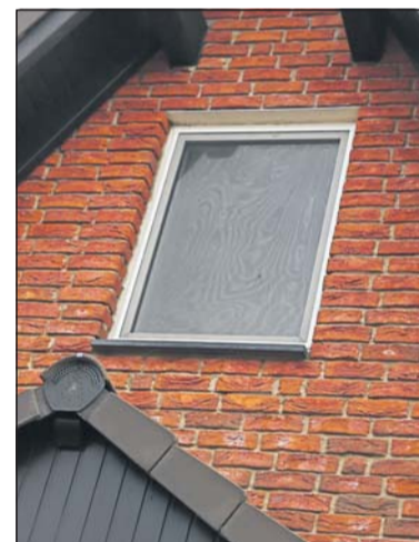
Im Fliegengitter des Badezimmersfensters ist ein Einschussloch.
